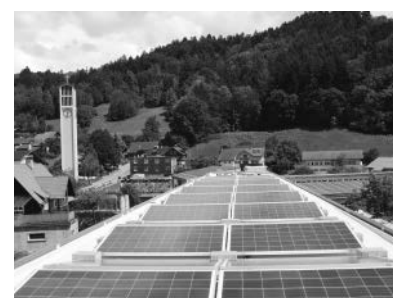
PV Anlage Frödichsaal
